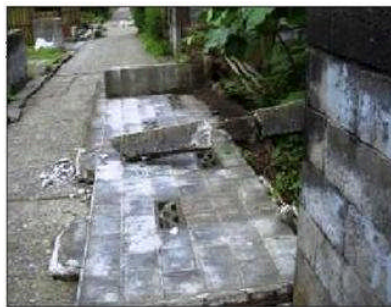
ブロック塀の倒壊
