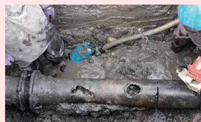
漏水した配水管の様子
