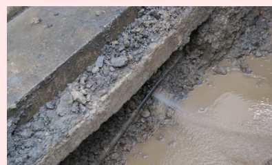
古い給水管漏水の様子
