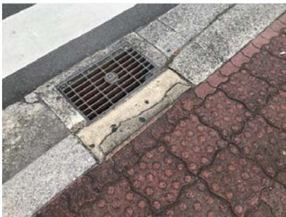
△側溝蓋の穴が動線上にある 誘導用ブロックが舗装と同色 でわかりにくい
