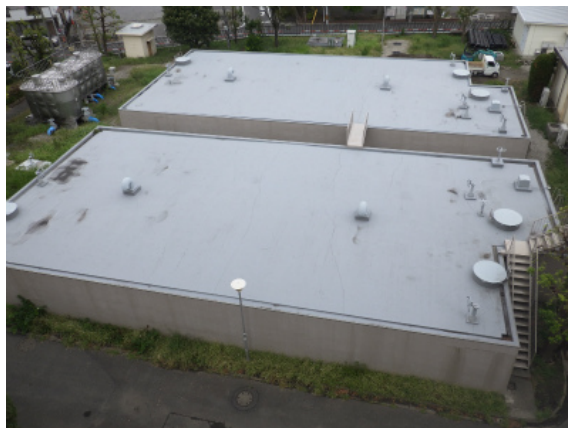
写真：西部浄水場井水用配水池
