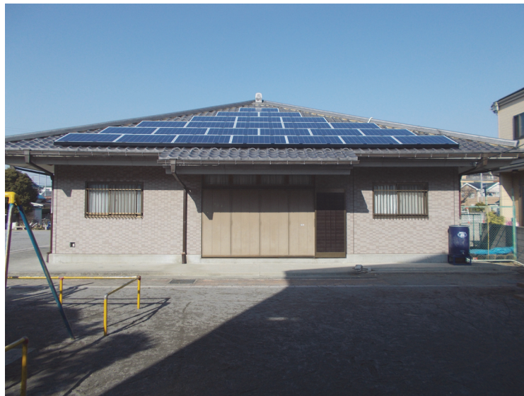
太陽光発電システム
